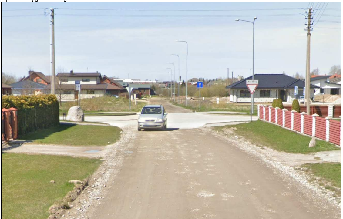
3 pav. Laukų gatvės dangos būklė ties sankryža su Laisvės g.
