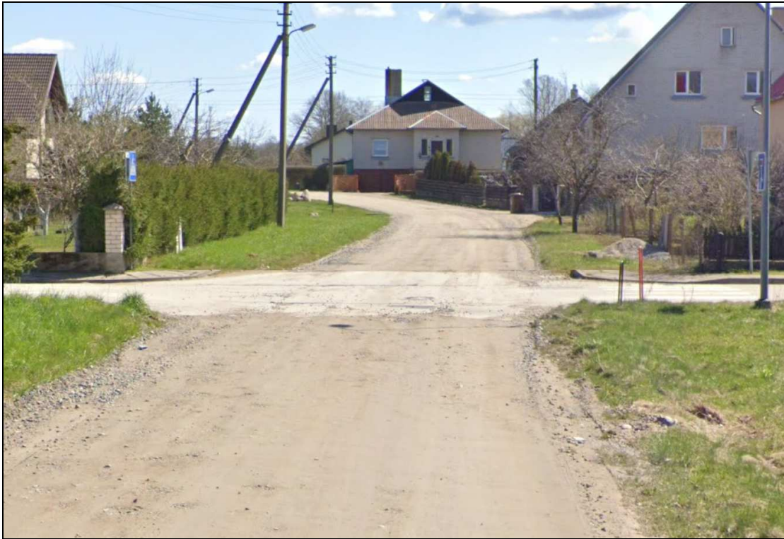
4 pav. Laukų gatvės dangos būklė ties sankryža su S. Daukanto gatve.
