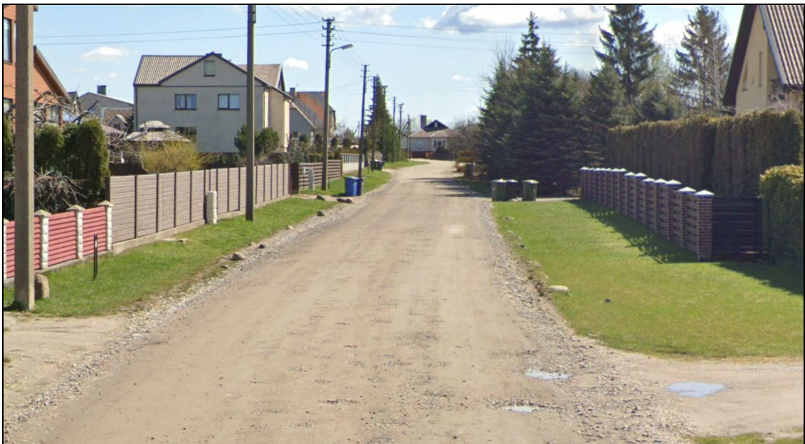
2 pav. Laukų gatvės dangos būklė
