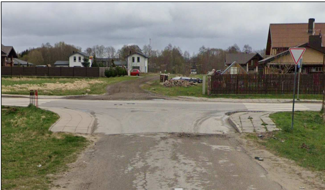
5 pav. Laukų gatvės dangos būklė ties sankryža su P. Vileišio gatve.
