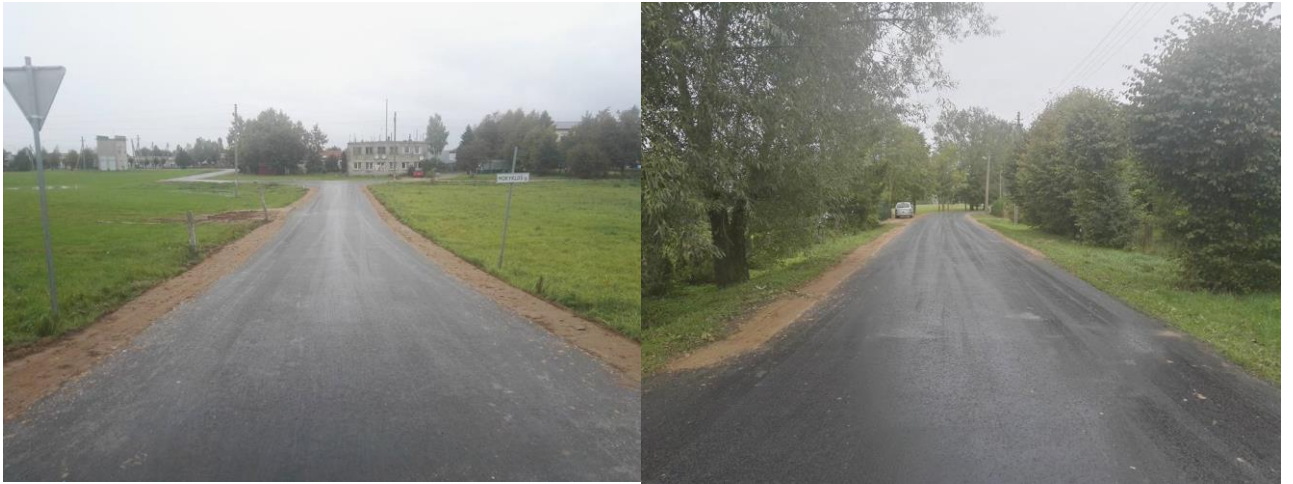
35 pav. Mokyklos g. dalies, Vydmantų kaime, asfalto dangos įrengimas ir asfalto dangos atnaujinimas
